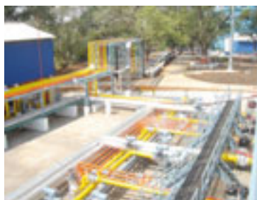
Manifold met vast leidingwerk
