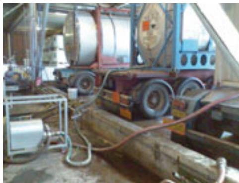
Onderlossing tankcontainers op trailer
