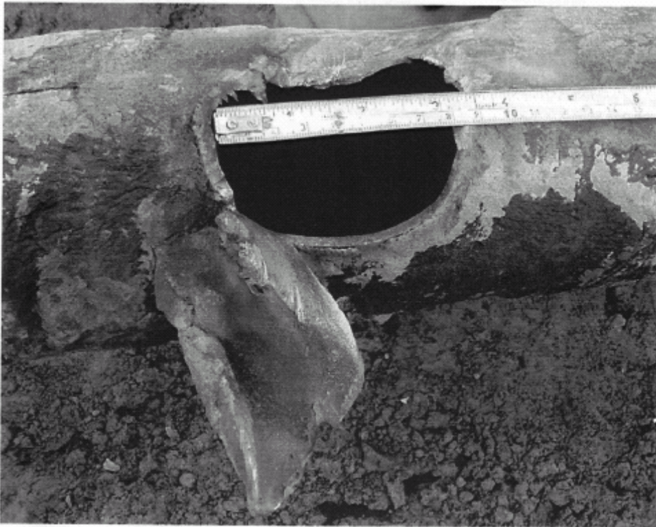
Figuur 1.1 Beschadigde buisleiding (incident Pannerden)
