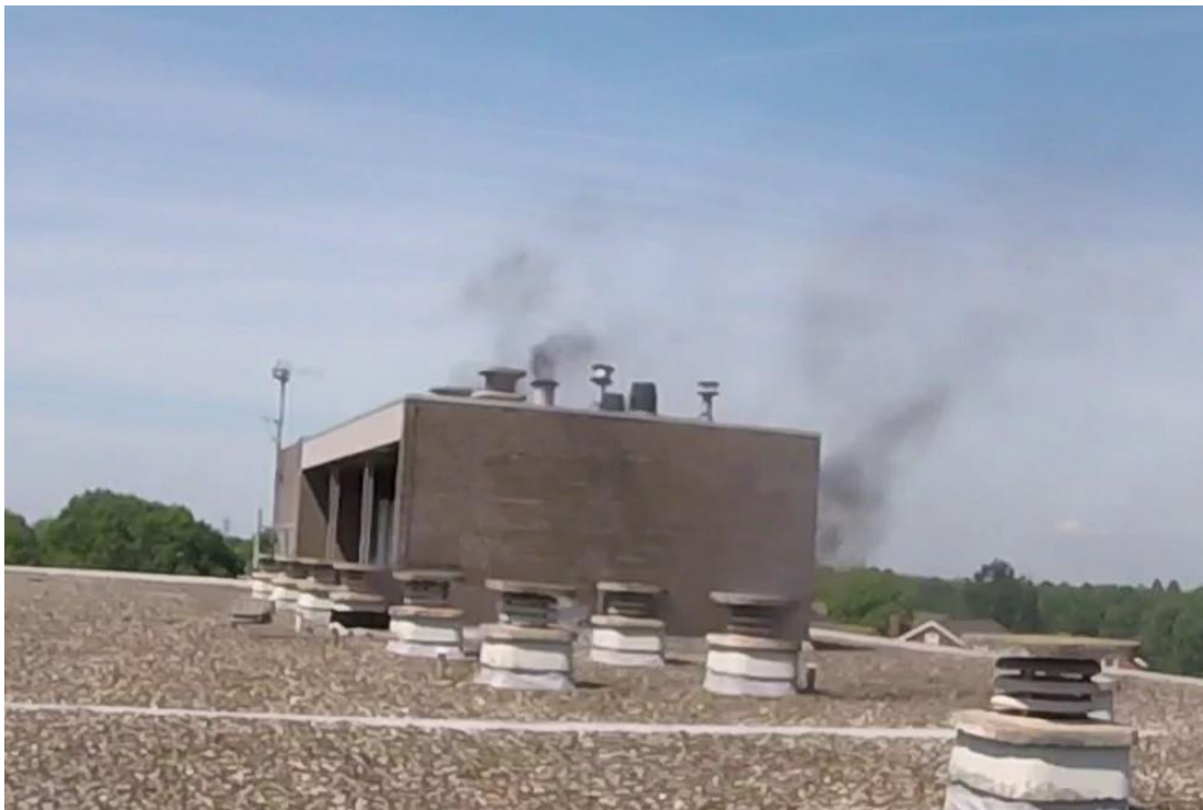
Figuur 1 Ventilatiekanalen op het dak
