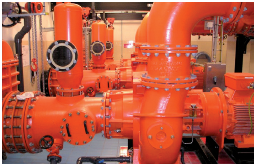
Figuur C.9 / Pompinstallatie.
