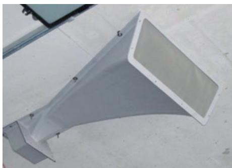
Figuur C.6 / Luidspreker in tunnel.
