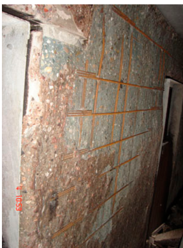
Figuur 10: Verkleuring van het beton
