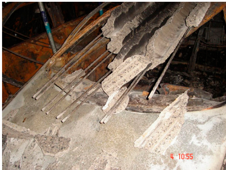
Figuur 23: scheur leidt tot vrijkomen strengen, die soms volledig uit het beton getrokken zijn waarna de onderhelft van de plaat op een auto is gevallen
