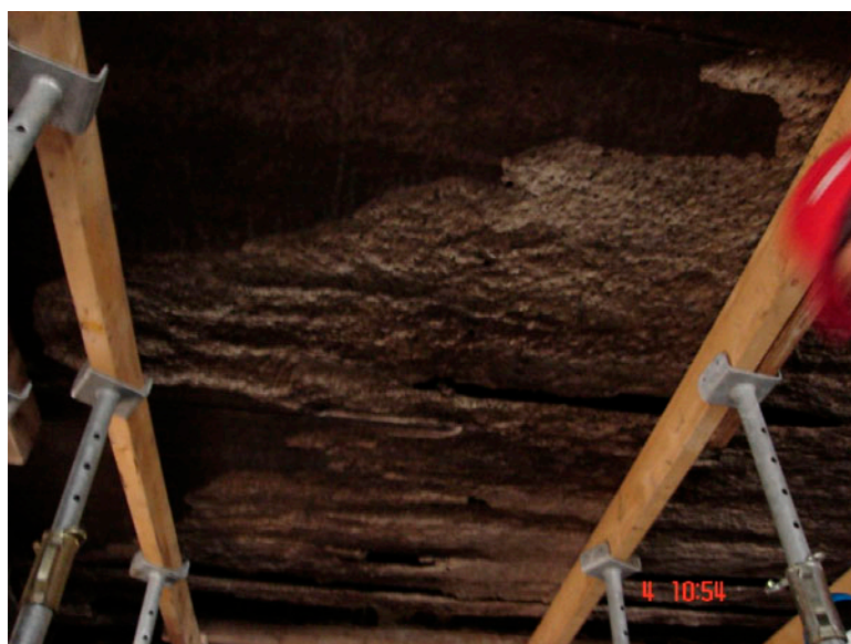
Figuur 17: afgespatte onderzijde van de kanaalplaat (iets verder van de brand vandaan). Te zien is dat de spatdiepte veelal tot aan de holle kanalen reikt.
