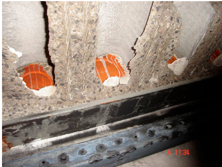
Figuur 22: scheur via het vlak van de voorspanstrengen, foto nabij de opleggingen
