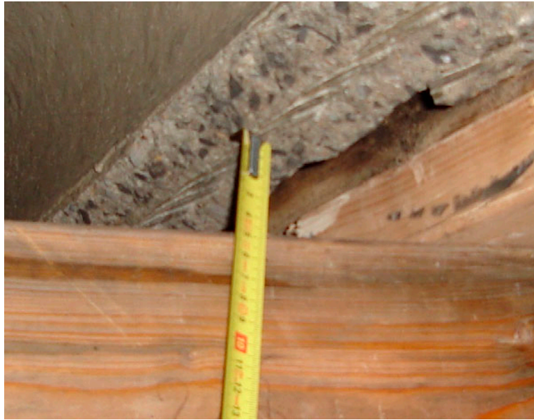
Figuur 20: de bovenkant van de streng lag op zo'n 5 cm van de voormalige onderzijde van de vloer, dus een betondekking van ca. 4 cm.
