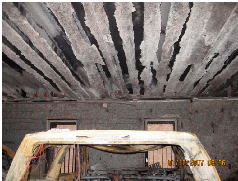
Figuur 21: afgespat tot aan de holle kanalen, maar de voorspanstrengen zijn dan nog bedekt. (foto Bouw en Woningtoezicht Rotterdam)
