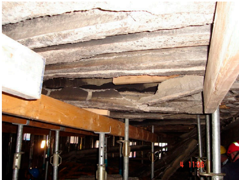
Figuur 25: in sommige gevallen is de onderhelft van de plaat nog blijven hangen doordat de strengen aan beide uiteinden wel in de opleggingen vast zijn blijven zitten
