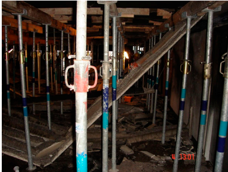
Figuur 24: gevallen onderhelft van de vloer aan het andere uiteinde. Rechtsboven steken de strengen nog in het beton boven de oplegging.
