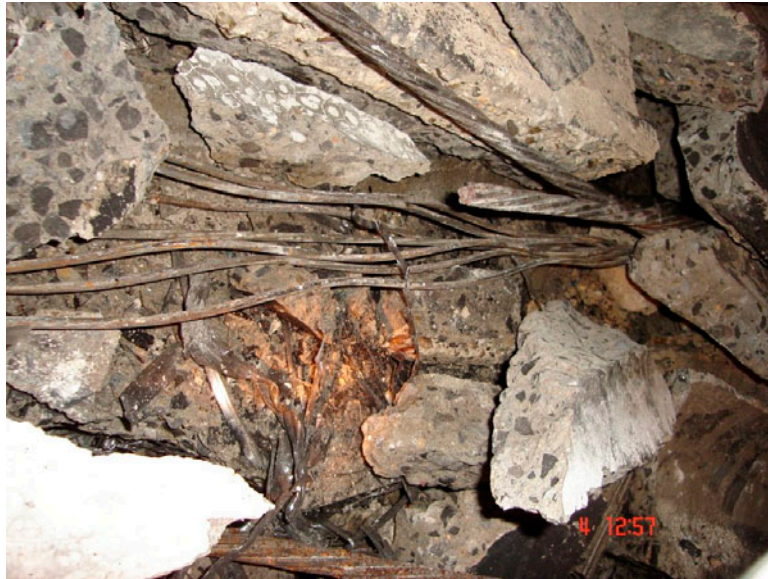
Figuur 18: enkele strengen waren volledig uit elkaar gedraaid doordat deze uit hun bedding zijn getrokken tijdens bezwijken onderkant vloer. De meeste strengen zijn niet uit elkaar gedraaid, doordat de bedding van de streng door scheurvorming reeds verruimde.
