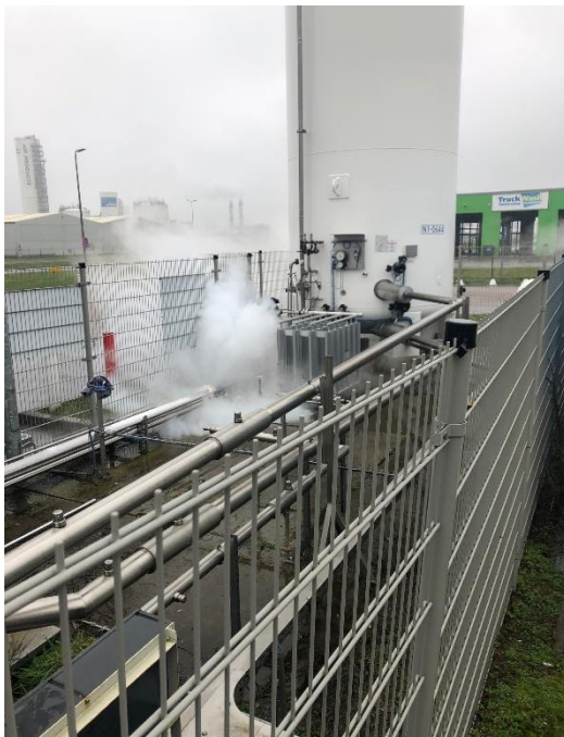
Afbeelding 8.2 Lekkage van de LNG-tank (foto: Veiligheidsregio Rotterdam-Rijnmond)
