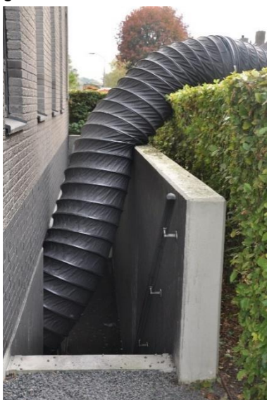
Foto 10: Zuigbuis van grote ventilator uit deur nooduitgang parkeerkelder.
