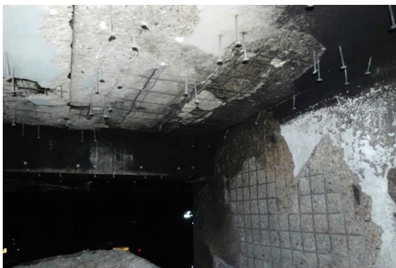
Foto 22: Afgespat beton met blootliggend betonijzer.
