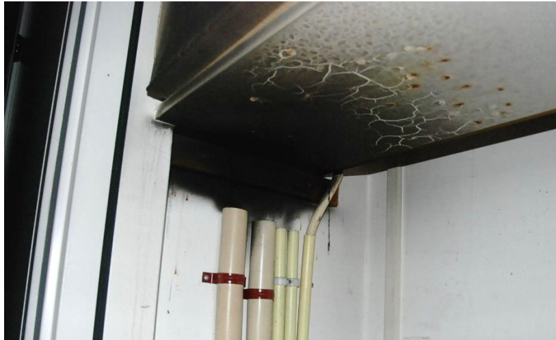
Foto 24: Loze leidingen in de bovenliggende meterkast.
