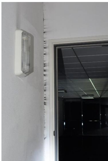
Foto 12: Kieren in ventilatiekanaal trappenhuis op de vierde verdieping.
