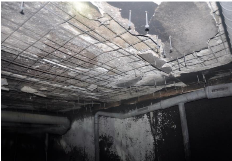
Foto 20: Afgespat beton met blootliggend betonijzer vloerdeel.
