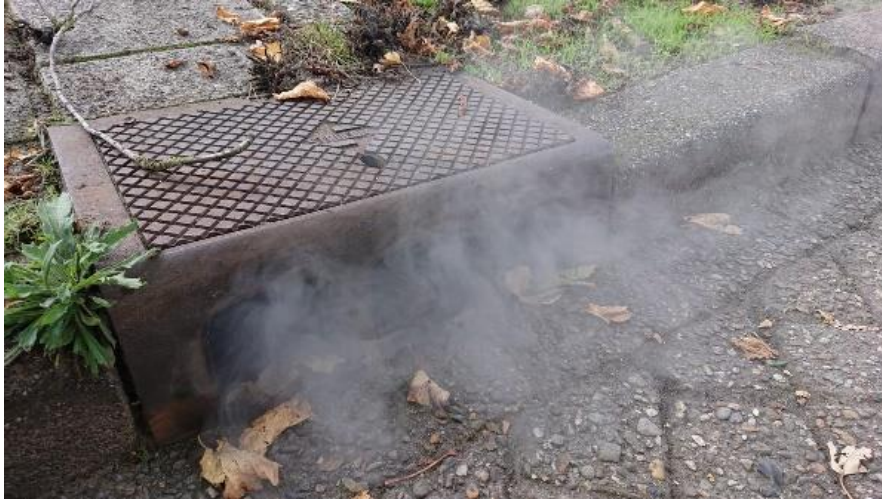
Foto 8: Rook uit een straatkolk aan de Stadhouderslaan (overzijde van het pand).
