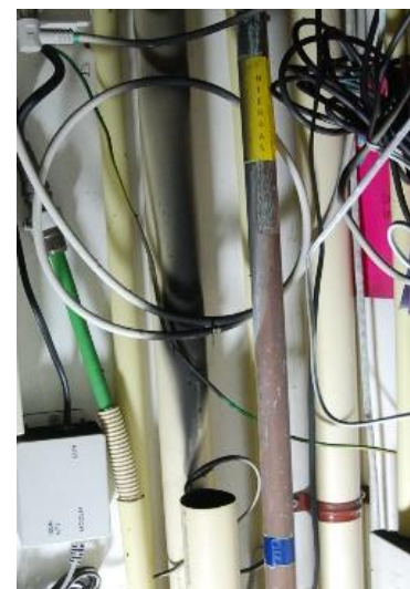
Foto 11: Loze mantelbuis in meterkast op eerste verdieping.
