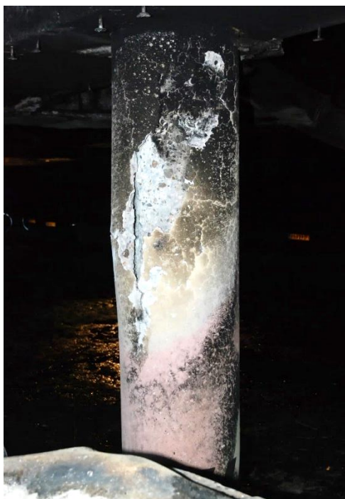
Foto 12: Gescheurde betonnen kolom.
