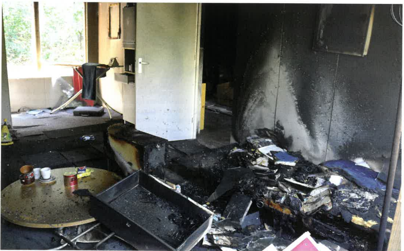
De schuimvullingen van meubels vatten snel vlam en veroorzaken razendsnel fatale rook.
