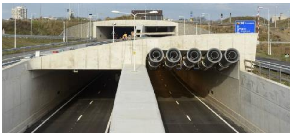
Figuur 9. Ventilatoren in de tunnelmond
