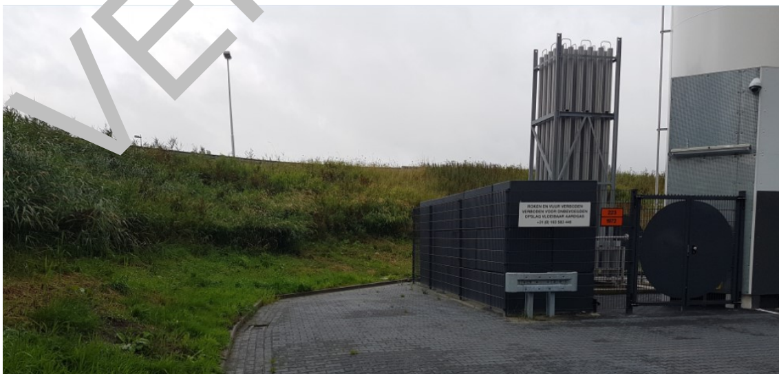
Afbeelding 10: Voorbeeld het toepassen van betonnen buildingblocks ter bescherming van de LNG installatie (bron: werkgroep)
