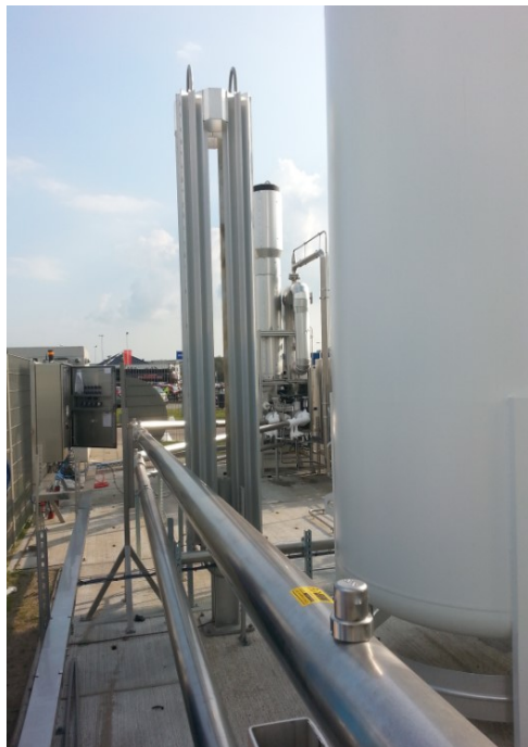
Afbeelding 16: Leidingwerk LNG installatie
