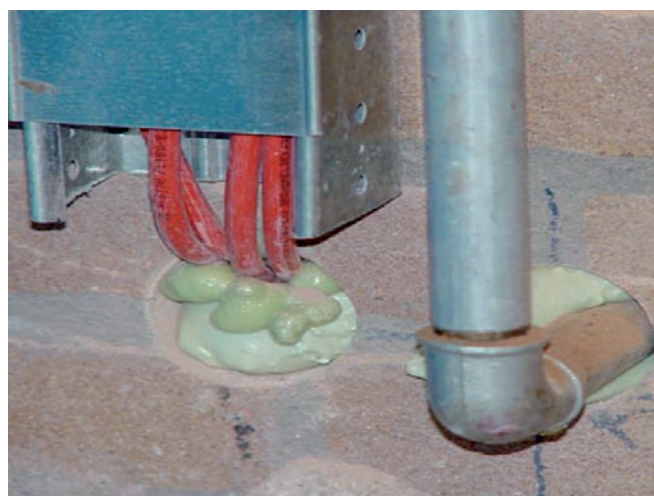
Foutieve afdichting van kabels en een geval van een rioleringsbuis metalen leiding
