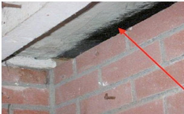
Ongewenste situatie: open ruimte tussen scheidingsmuur en het dakbeschoot
