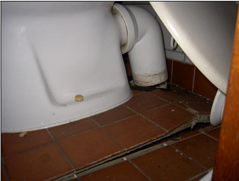
Afbeelding 10: Toilet die op de vuilwatertank was geplaatst. De omhoog gedrukte vloer is op deze afbeelding duidelijk zichtbaar (foto: TNO Bouw en Dienstverlening)
