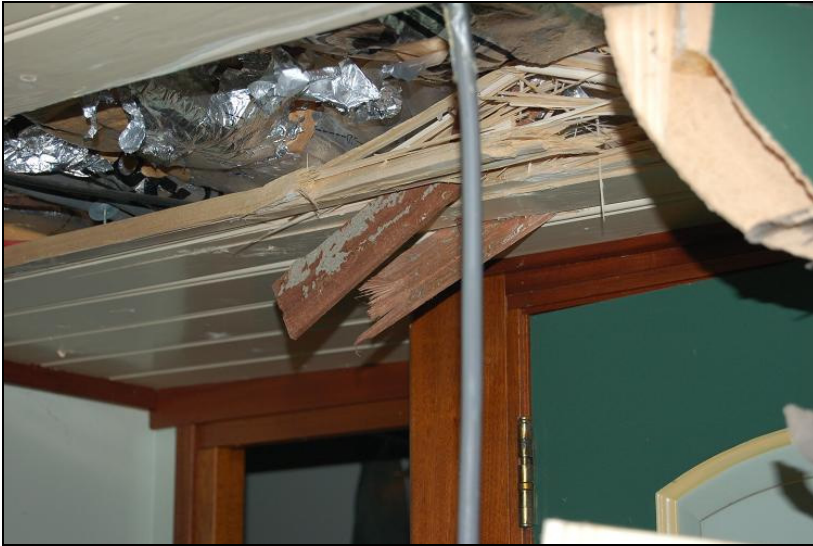
Afbeelding 9: Schade aan het plafond. Delen van de laminaatvloer hebben zich in het plafond geboord (foto: TNO Bouw en Dienstverlening)
