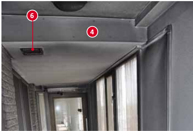
Afbeelding 41: Ventilatie-rooster galerij in verlaagd plafond
