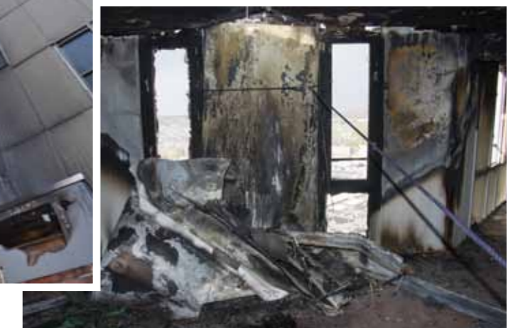
Afbeelding 22: Brandschade 5 e verdieping
