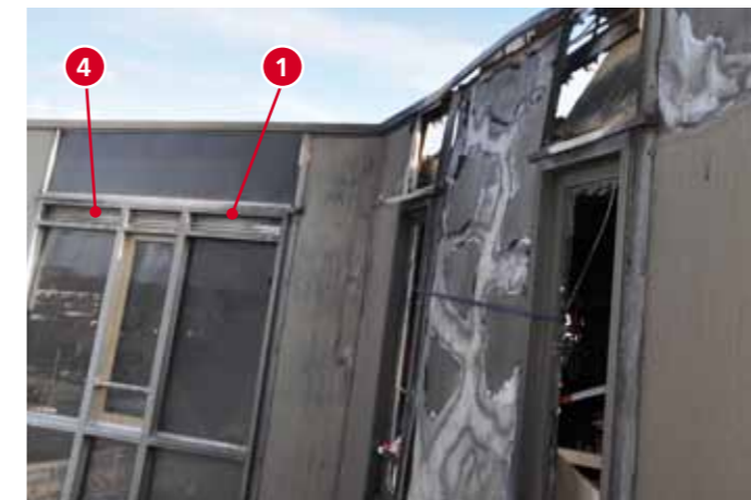
afbeelding 38: Ventilatie-roosters buitenzijde (1 en 4)
