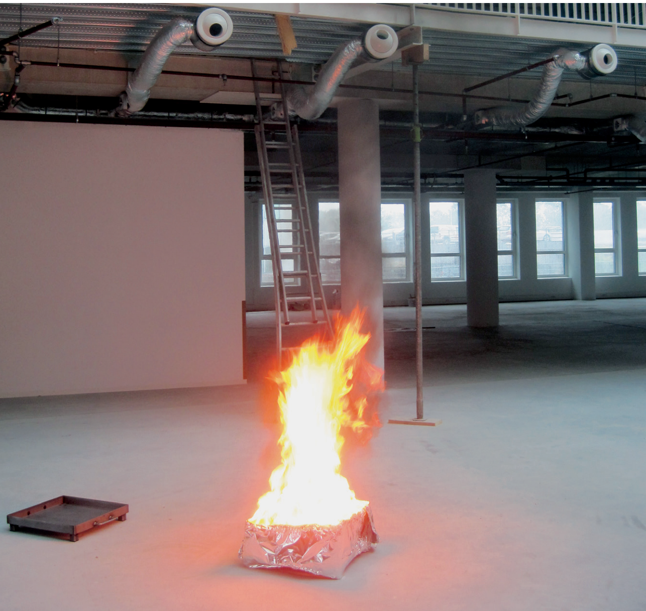
Toelichting foto: Onderdeel van de oplevering van een brandmeldinstallatie kan zijn het uitvoeren van een proefbrand om de werking van automatische melders aan te tonen.
