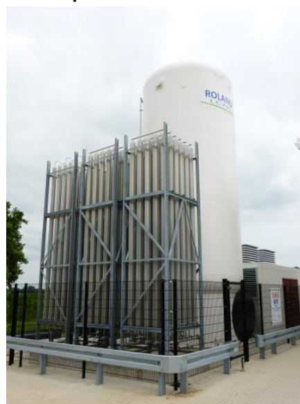
Afbeelding 4.6 Opslagtanks met verdamper
