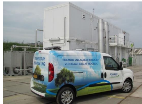
Afbeelding 3.5 Opwerkingsinstallatie voor groen gas van Attero
