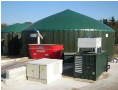
Afbeelding 3.4 Biogasinstallatie in landbouwgebieden
