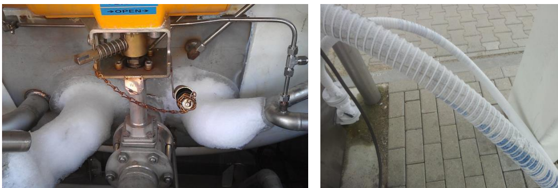
Afbeelding 7.3 IJsvorming op slangen tijdens het lossen
