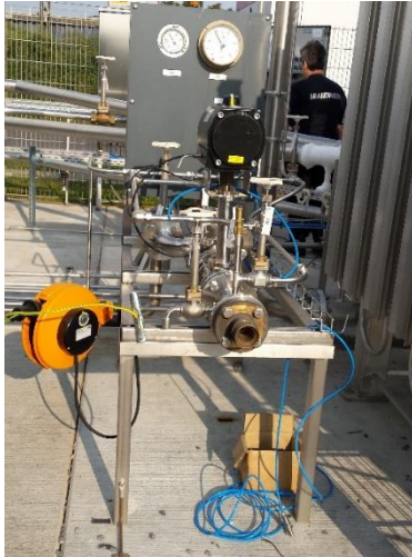
Afbeelding 7.4 Laadpunt met aardkabel voor het lossen bij een LNG-tankstation
