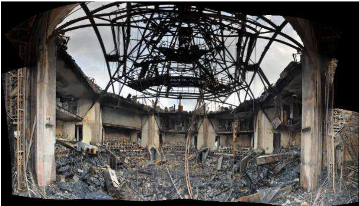
Foto 11: Theaterzaal na de brand
