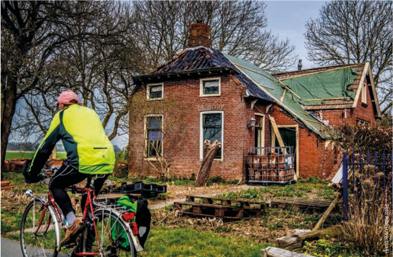
Beschadigde woning in Loppersum.
